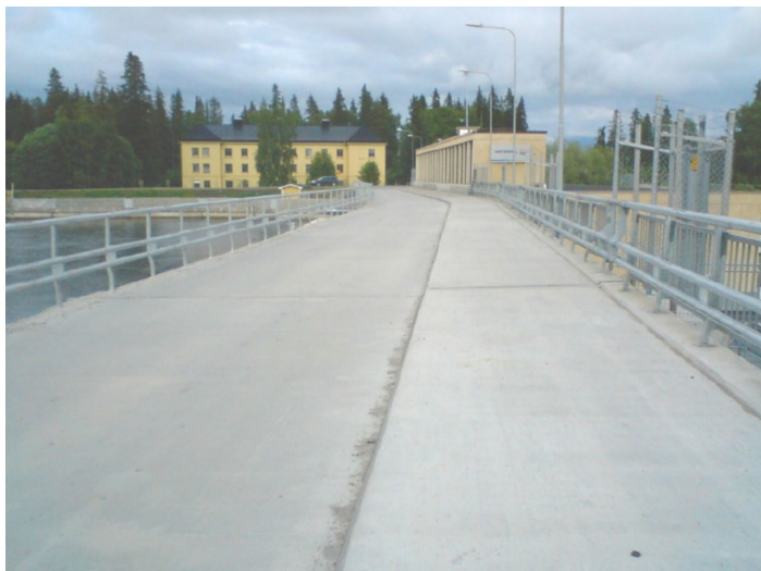
Figur 5.1 Demonstrationsprojekt i Trafikverkets regi, Bodens kraftstation, Luleå älv med variation av utförande och armering. Inga sprickor eller vidhäftningssläpp observerades, Carlswärd (2008).. Foto Jonas Carlswärd.
